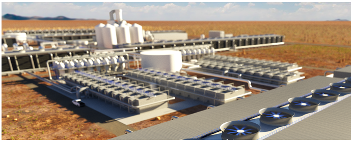
Photo : Occidental Petroleum
